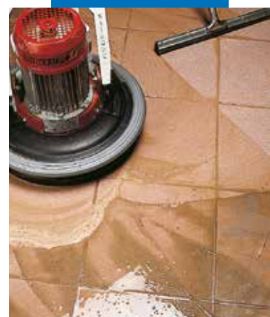
Finition des joints de grès cérame à la raclette et à la monobrosse
